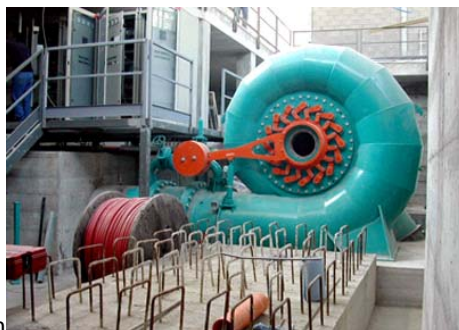
turbina da diga, diametro 3.00m
